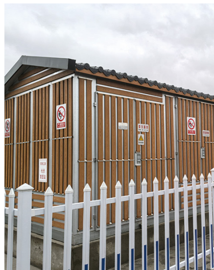
▲ 光伏高压站。李书渊 摄
